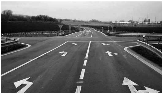
Obr. 2 Bývalá hlavní silnice se po rekonstrukci stala vedlejší, očekávání řidiče se však nezměnilo a výsledkem je nehodová lokalita na nově postavené křižovatce
